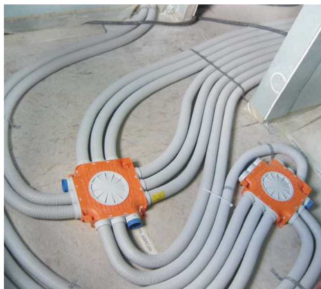
Instalacja NeoFlexGOLD na stropie przygotowana do ukrycia w konstrukcji wylewki
